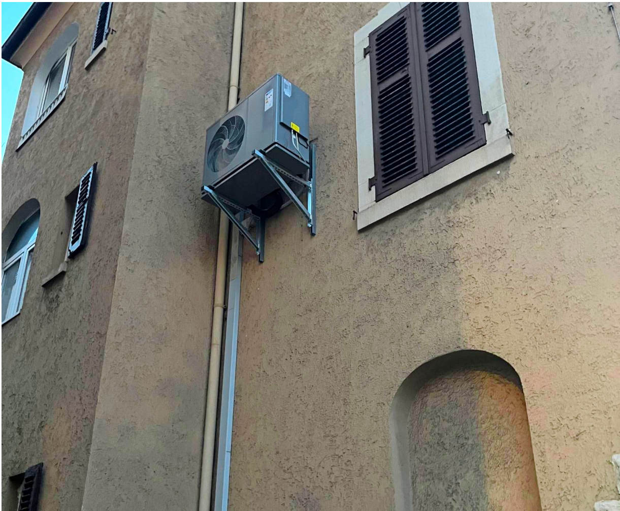
Das Außengerät der Wärmepumpe kann an der Hauswand oder auf einem Balkon angebracht werden. In zwei Häusern in Stuttgart und einem in Heilbronn laufen die Anlagen seit vergangenem Jahr erfolgreich im Probetrieb.
